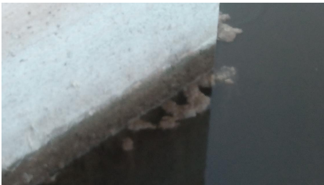
Foto 1. Marca de humedad que demuestra el brusco descenso de nivel del agua entre el 4 y el 5 de Agosto en el punto A de la Figura 1.
